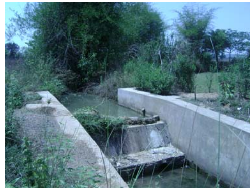
Field drain at Dalaksahi to Dihagaon (Kuanria))
